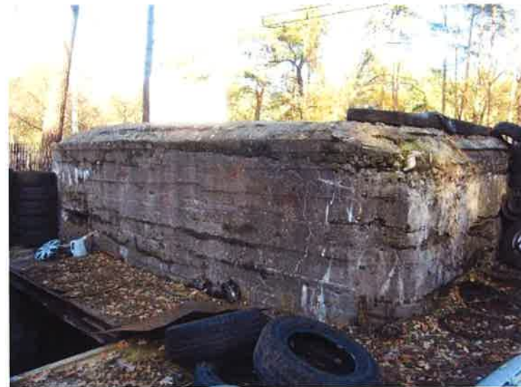
Fot. 44. Schron bojowy (4d) - widok z południowego wschodu na ścianę prawą z wejściem do przelotni, dostępnym przez zejście do współczesnego kanału rewizyjnego (schodki poza kadrem) i ścianę czołową zasypaną do poziomu dolnej krawędzi strzelnicy ckm.
