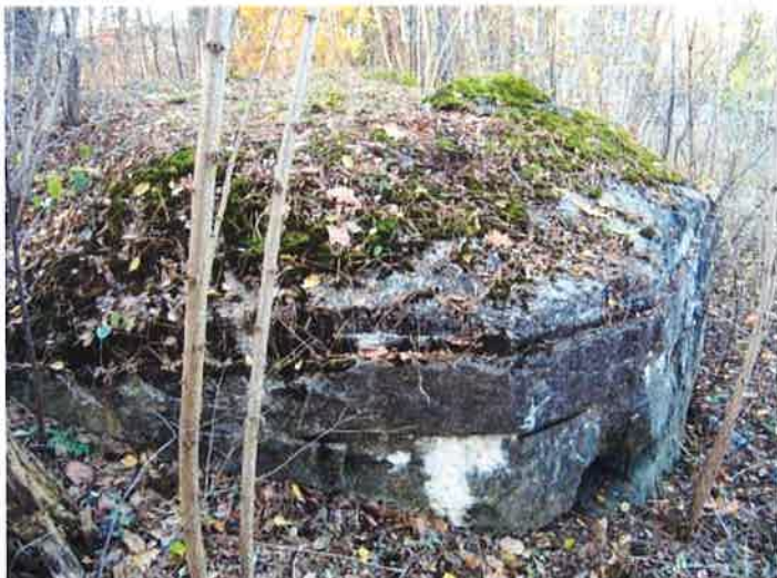
Fot. 31. Schron obserwacyjny (3b) - widok z południowego wschodu na ścianę czołową z częściowo zachowanym tynkiem maskującym i uszkodzeniem krawędzi szczeliny obserwacyjnej. Na stropie po prawej wzniesienie zaczopowanego otworu dla peryskopu.
