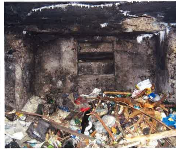
Fot.29. Wnętrze schronu (3a) - okopcone i zasypane śmieciami, widok na wnękę z otworem obserwacyjnym w ścianie czołowej. Okładzina stropu wtórna.
