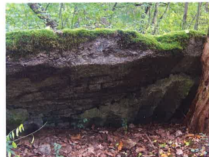
Fot. 4. Spodnia część płaszcza schronu (1d) - widoczne odciski belek, odspojenie warstwy wyrównawczej, odcisk i resztki siatki zbrojenia oraz drobnoziarnista struktura betonu.
