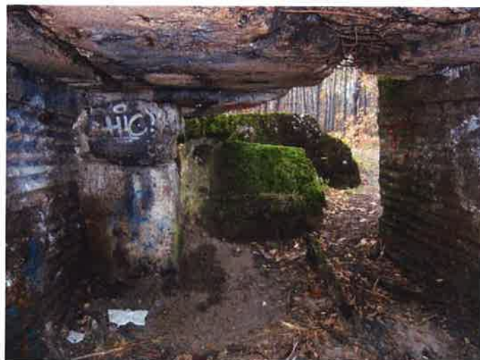
Fot. 12. Wnętrze schronu (1g) - widok z izby bojowej na zachowaną prawą część ściany działowej (po lewej stronie kadru) z bocznią krawędzią i nadprożem otworu wejściowego, za nią leżącym wewnątrz przelotni fragmentem stropu (pochodzącym z wyrwy, widocznej po prawej stronie u góry) i ścianę tylną przelotni.
