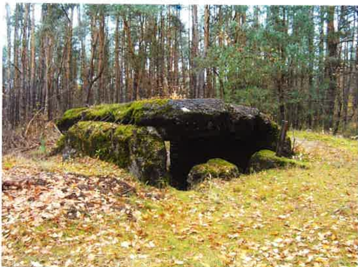
Fot. 8. Schron bojowy (1g) - widok z południa. Widoczne położenie schronu na szczycie lokalnego wzniesienia, odsłonięta po osunięciu się nasypu maskującego górna część prawej ściany i popękany od wybuchu strop. Ściana czołowa z oderwaną górną częścią odchyloną i wciśniętą w nasyp, z częściowo zasypianym, rozglifionym otworem strzelniczym ckm i szyną zbrojenia.
