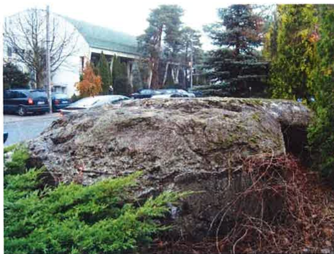
Fot. 21. Schron (2d) - widok z południa na przesłoniętą zielenią ścianę czołową i lewą z aneksem przedsionka. Widoczne duże uszkodzenia wierzchniej warstwy stropu i górnej partii ściany, na ścianie i zachowanych skosach nie ma rowków i śladów tynku.
