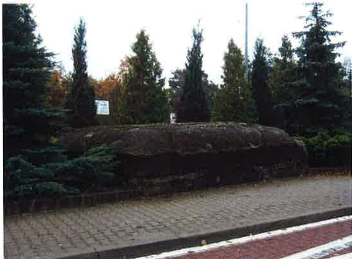
Fot. 20. Schron obserwacyjny (2d) - widok z północy na ścianę tylną (przesłoniętą zielenią) i prawą. Wierzchnia warstwa betonu nie została uszkodzona przez warunki atmosferyczne, ubytki pojawiły się na linii połączenia warstw i od uszkodzeń mechanicznych.
