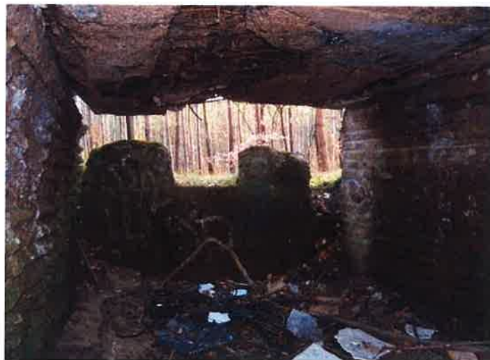
Fot. 11. Schron (1g) - widok na wnętrze izby bojowej od strony wejścia. Na wprost ściana czołowa ze strzelnicą ckm, na bocznych ścianach odcisk zerwanej blachy falistej, w popękanych i wygiętym stropie odsłonięte zbrojenie i ślady po dwóch zatopionych w betonie wzdłużnych listwach.
