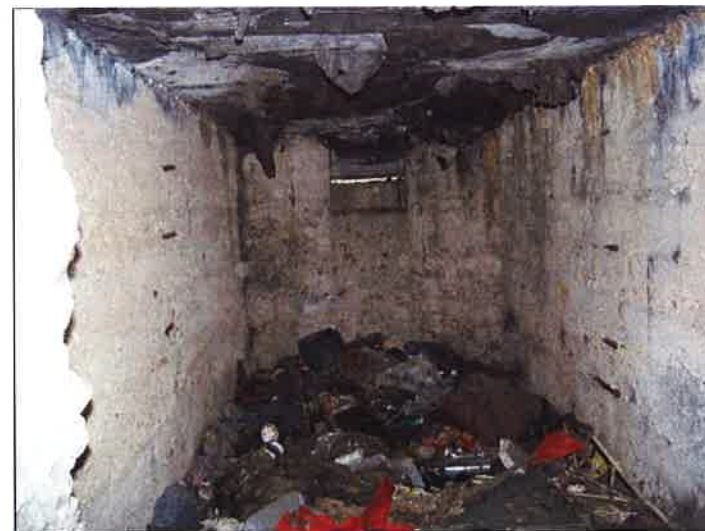
Fot. 41. Schron (3f) - wnętrze „wąskiej” izby obserwatora (170 cm) w widoku z przelotni, częściowo zasypane śmieciami. W ścianie czołowej otwór obserwacyjny z wnęką, na bocznych widoczne fragmenty zbrojenia. Strop oklejony wtórnie papą, zasłaniającą pierwotne otwory.
