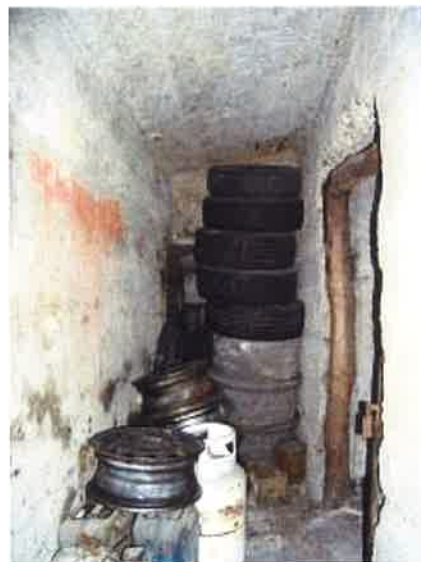
Fot. 46. Schron (4d) - wnętrze przelotni ze skośnym stropem. Na wprost zamurowane wejście wschodnie z elementami drewnianej ościeżnicy, z prawej wejście do izby bojowej z widocznym węgarciem.
