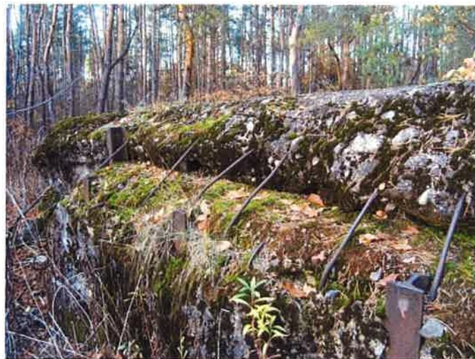
Fot. 9. Schron (1g) - pęknięcie i ubytki na styku prawej ściany i stropu, widoczne zbrojenie: pręty zewnętrznej siatki i górną końcówki wzmocniających ścianę pionowych szyn kolejowych, rozmieszczonych naprzemiennie w dwóch rzędach.
